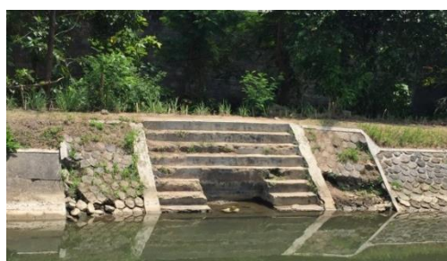
Gambar 2. Kerusakan pada dinding selokan Mataram
