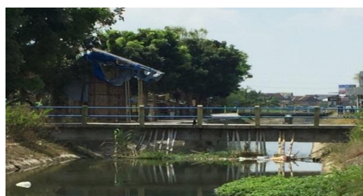
Gambar 3. Jembatan yang mulai retak dan perlu penyangga
