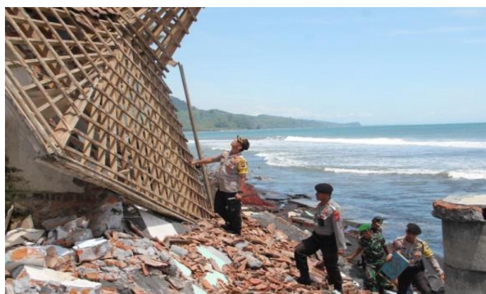
Gambar 9. Foto Mushola dan Pondasi Rumah Warga Roboh Akibat Pondasi Tererosi Tahun 2018
