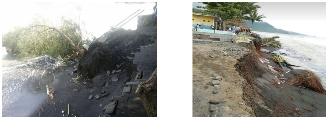
Gambar 8. Foto dampak Erosi Pantai TPI
