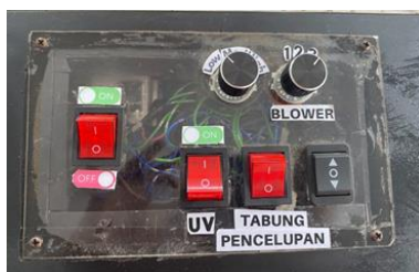
Gambar 9. Control Panel Laju Blower Teknologi Mesin Pengolahan Batik
