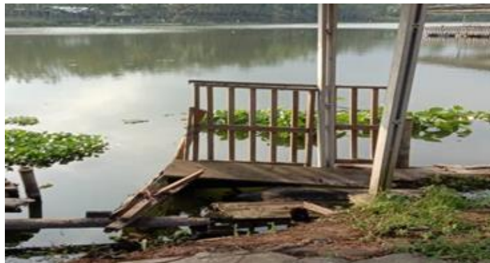
Gambar 4. Fasilitas Umum (Jembatan) yang rusak
