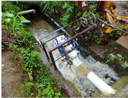
Gambar4. Rangkaian frame, turbin, dan generator
