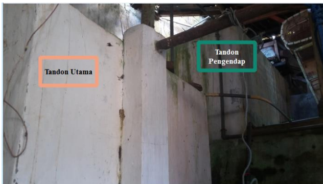
Gambar 1 Kondisi tandon utama dan pengendap di Desa Gadungsari
