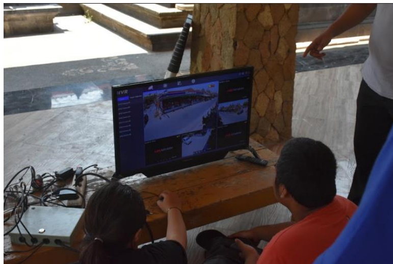
Gambar 7. Hasil Uji CCTV pada Stasiun CCTV
