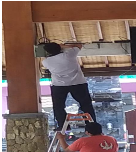
Gambar 2. Pemasangan CCTV di dalam Wantilan Banjar Sampalan
