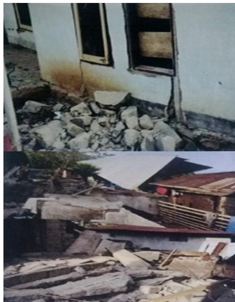
Gambar 5. Kerusakan bangunan rumah akibat gempa bumi di kecamatan Jailolo Selatan Kabupaten Halmahera Barat di bulan November 2015
