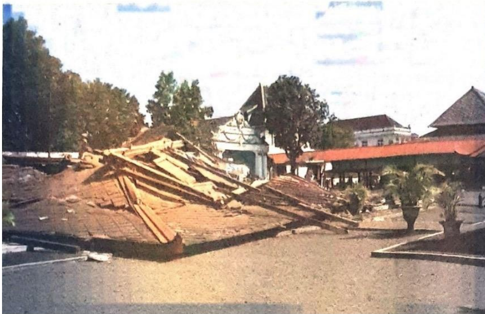
Gambar 4. Kerusakan Bangsal Traju Mas Akibat Gempa. Sumber: Kompas (2006a)
