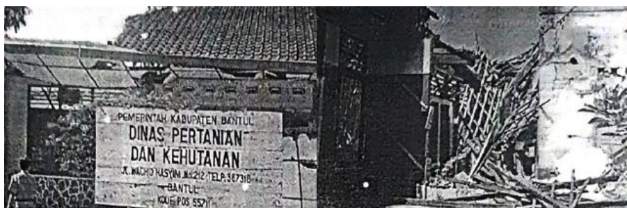
Gambar 6. Kerusakan Kantor Dinas Pertanian dan Kehutanan Kab. Bantul. Sumber: Dinas Pertanian DIY (2006a)
