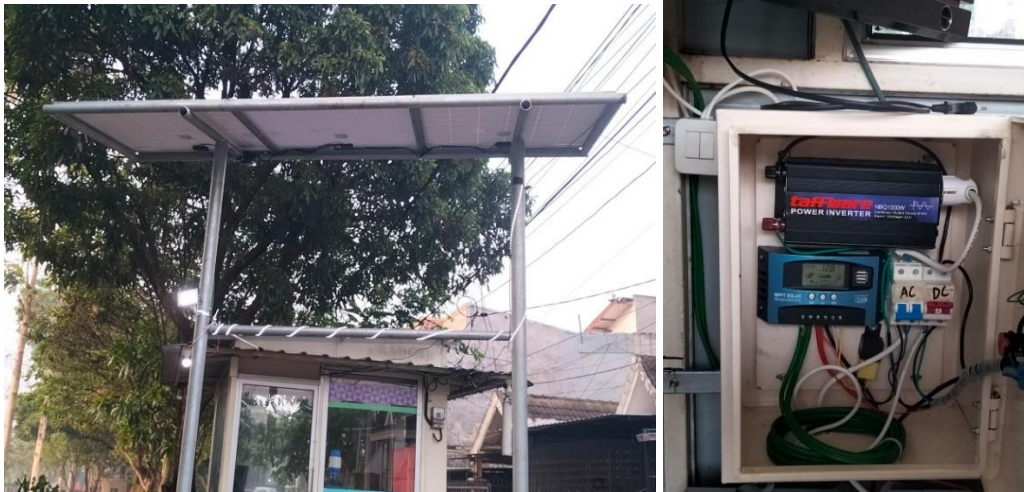
Gambar 5. Sistem PLTS yang Sudah Terpasang
